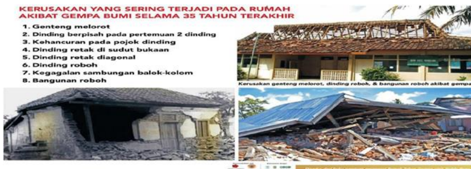
Gambar 10. Bentuk Kerusakan pada Rumah Akibat Gempa
